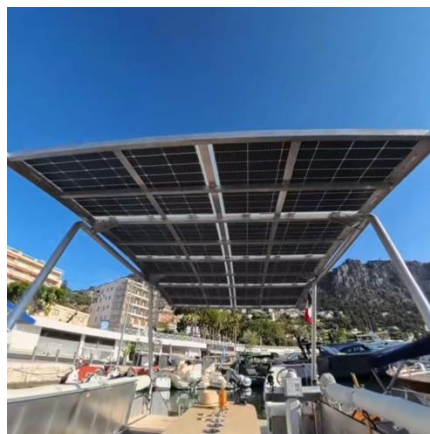
Canopée solaire 1600 Wc
