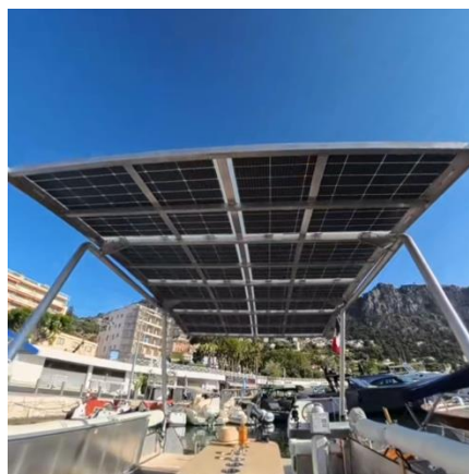
Canopée solaire 1600 Wc
